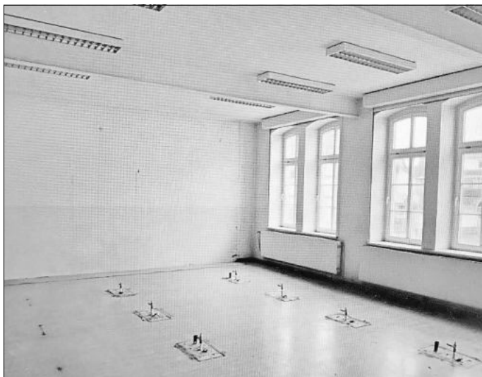
Blick auf einen früheren Schulsaal. Hier sollen die Büros der Verwaltung entstehen.
