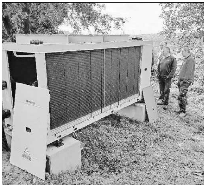
Gleichzeitig wurde die neue Wärmepumpe in Betrieb genommen.
