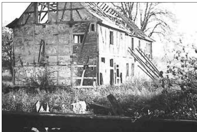
Die bereits stark zerstörte Giebelwand des Bauernhauses
